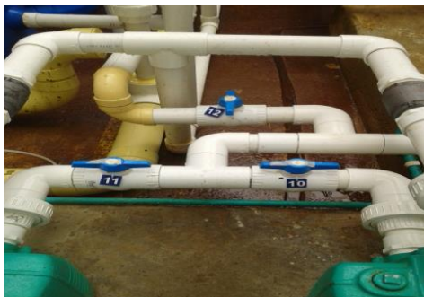
Ilustración 26. Válvulas de Filtración V10-NA y V11-NA, V12 By pass -NC
