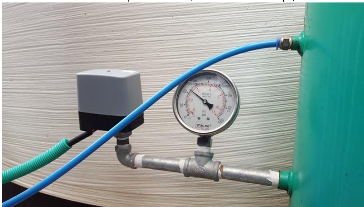
Ilustración 14. Manómetros tanque de saturación
