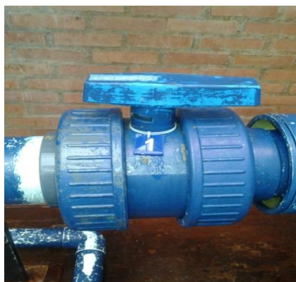
Ilustración 17. Válvula V1-NA-Entrada del agua al mezclador estático
